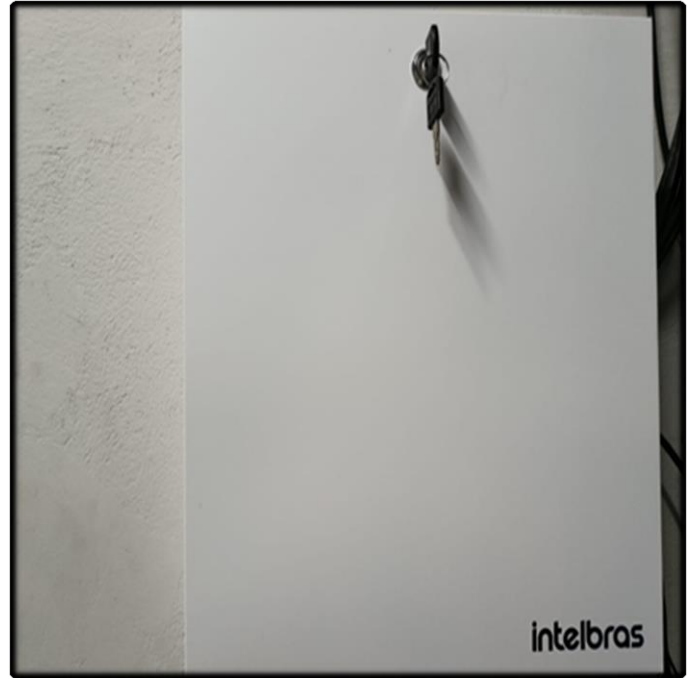
- Imagem do Rack Instalado
