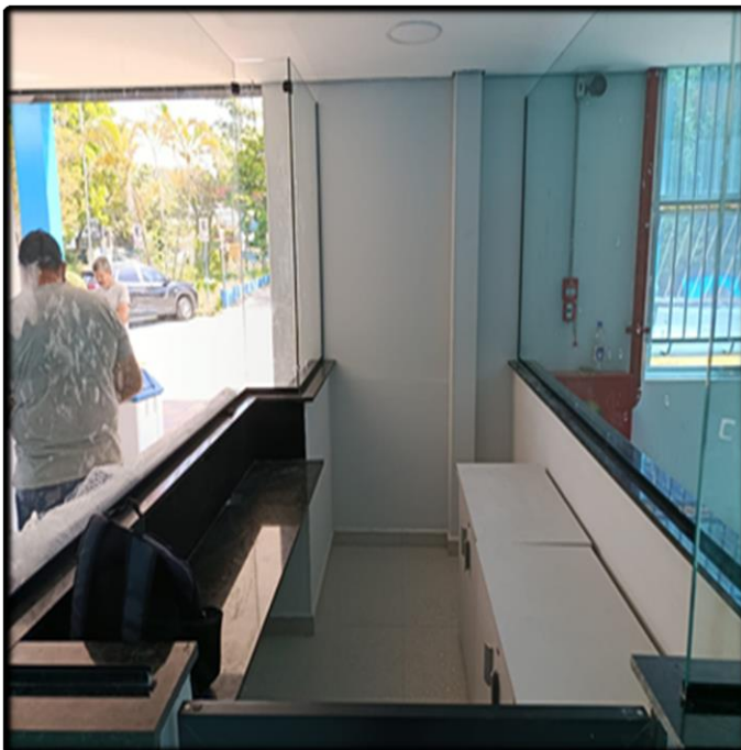
- Balcão Interno da Guarita com Eletrocalha Embutida
