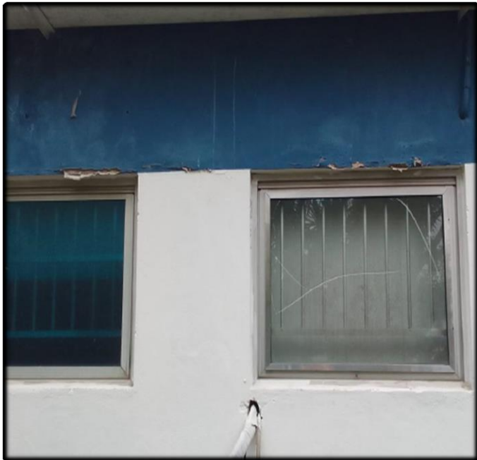
- Infiltração (Área Externa Lateral)
