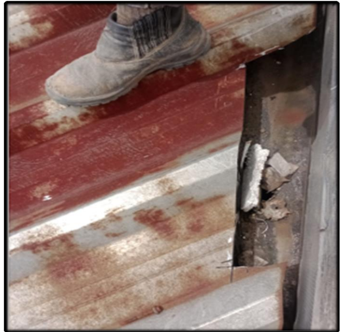
- Sujeira Acumulada (Degradação das Telhas)
