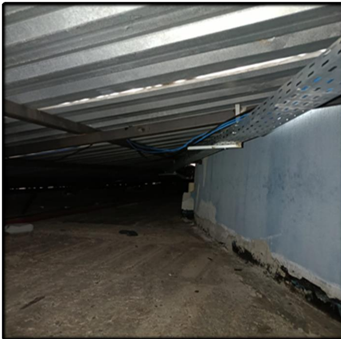
- Eletrocalha para a Infraestrutura Elétrica e Cabeamento
