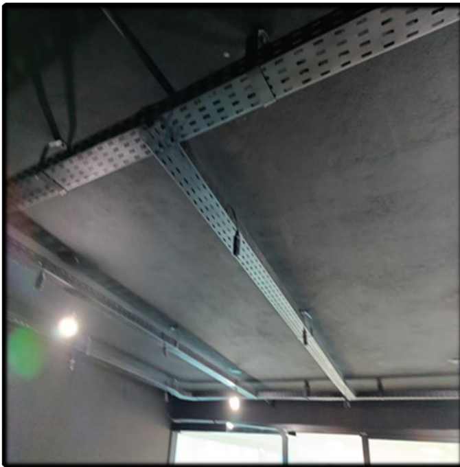
- Eletrocalha com Tomadas Elétricas Aéreas
