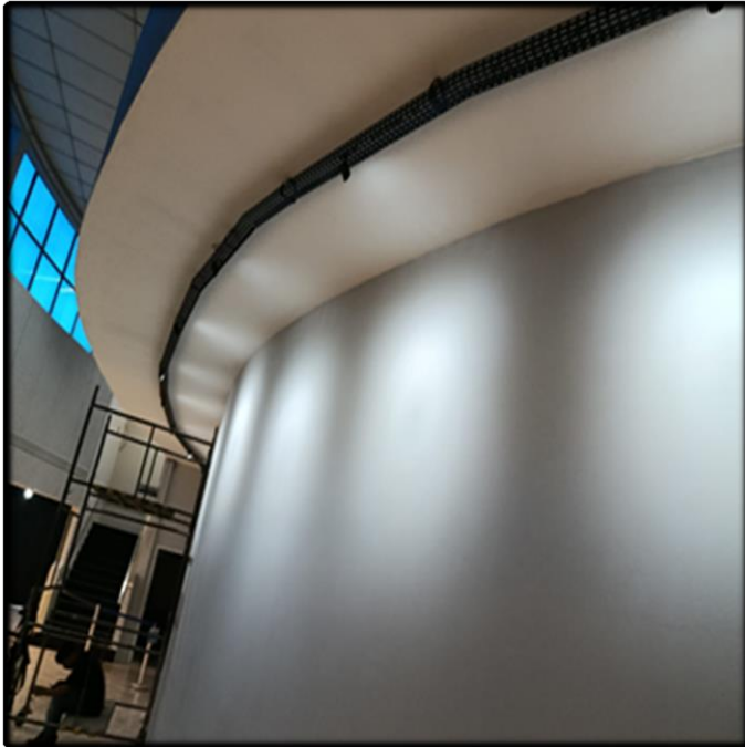
- Sistema de Eletrocalha com Spots de Iluminação
