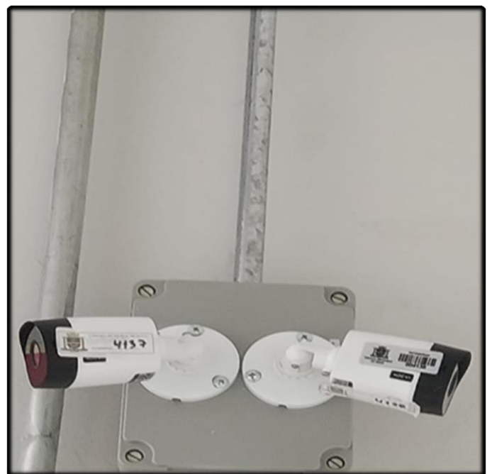
- Conjunto (Conduíte, Caixa de Passagem e Câmera)
