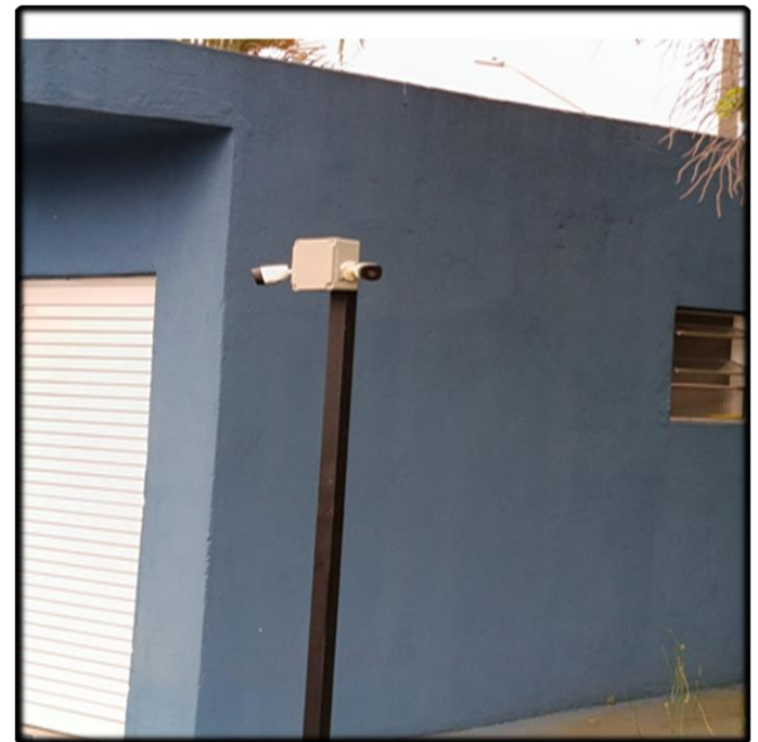
- Câmera Instalada no Portão de Entrada Principal
