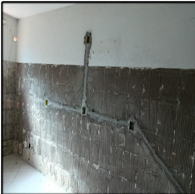
- Visão Geral dos Novos Pontos de Energia
