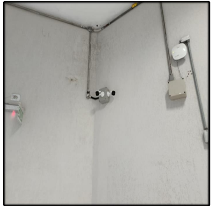
- Câmeras Instaladas no Corredor Principal
