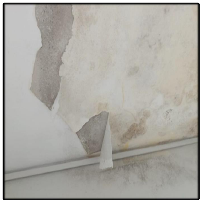
- Desgaste na Pintura
