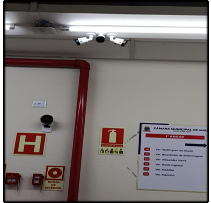
- Câmeras Junto à Escada de Acesso ao Prédio Anexo
