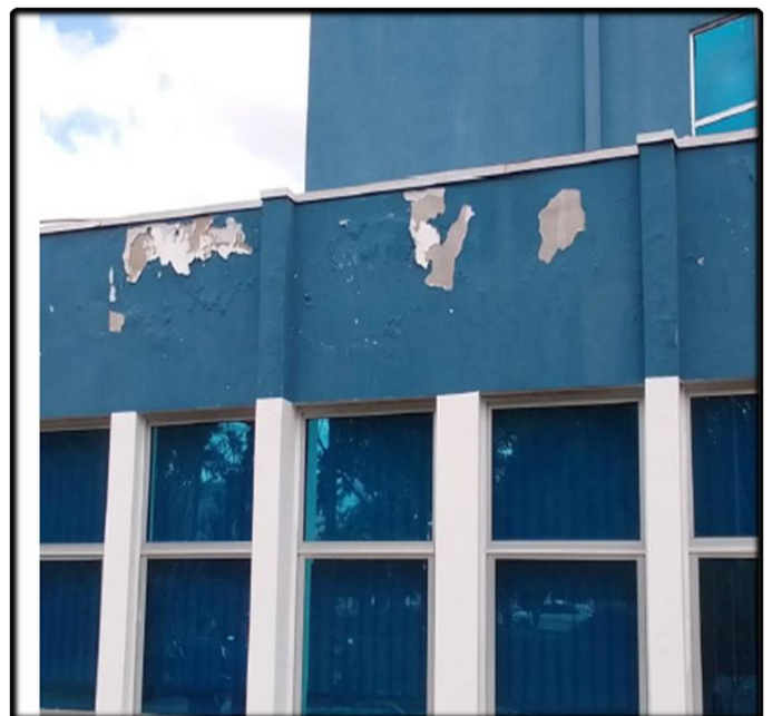
- Infiltrações e Vazamentos (Entrada Principal)
