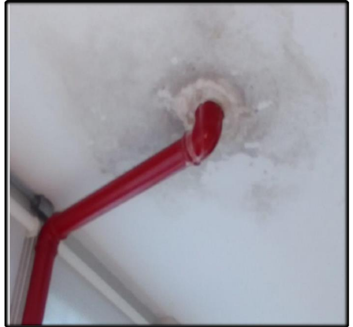
- Infiltrações e Vazamentos (Recepção)
