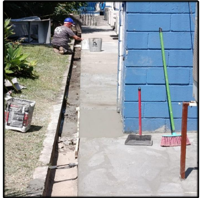
- Canaleta para Captação de Águas Pluviais
