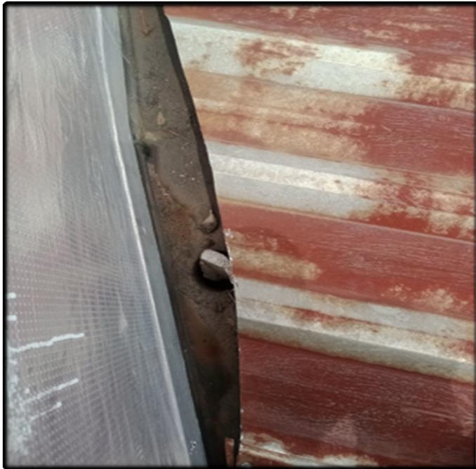
- Ferrugem e Corrosão na Estrutura Metálica
