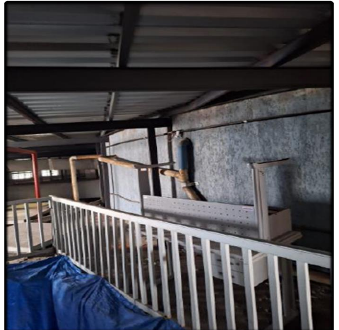
- Rede de Captação e Drenagem (Expostas)
