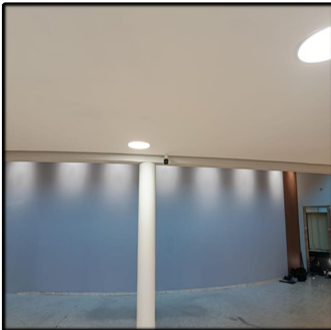
- Sistema de Vigilância Instalado na Recepção
