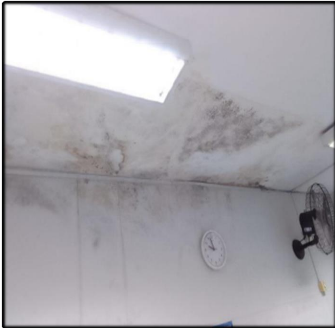
- Mofo e Vazamento (Copa)
