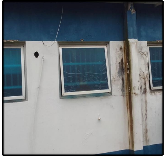
- Infiltração (Área Externa Lateral)
