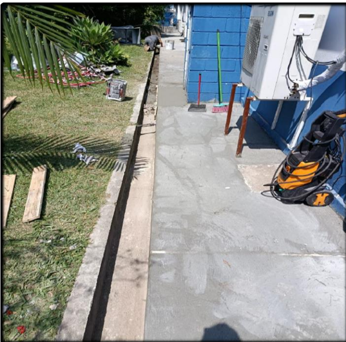
- Canaleta para Captação de Águas Pluviais
