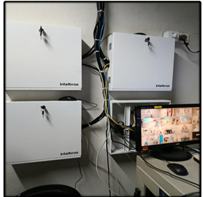
- Visão Geral do Data Center com os Racks Instalados
