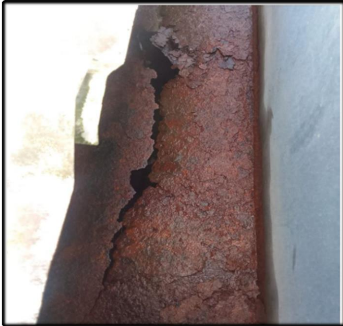
- Calha danificada (Corrosão)
