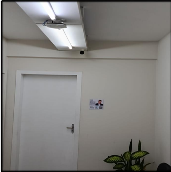
- Câmera Instalada no Piso Superior do Prédio Anexo
