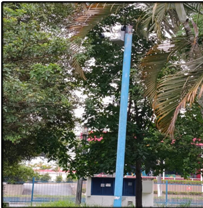
- Câmera Instalada no Estacionamento dos Servidores
