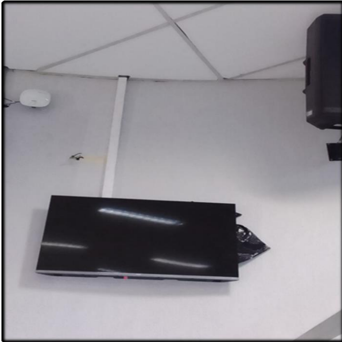
- Infiltração na Parede do Plenário
