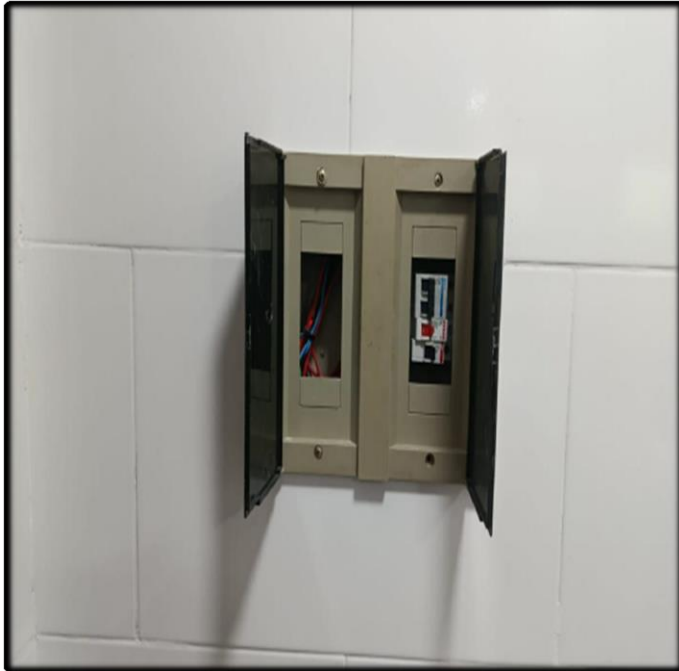
- Visão Geral dos Disjuntores Instalados
