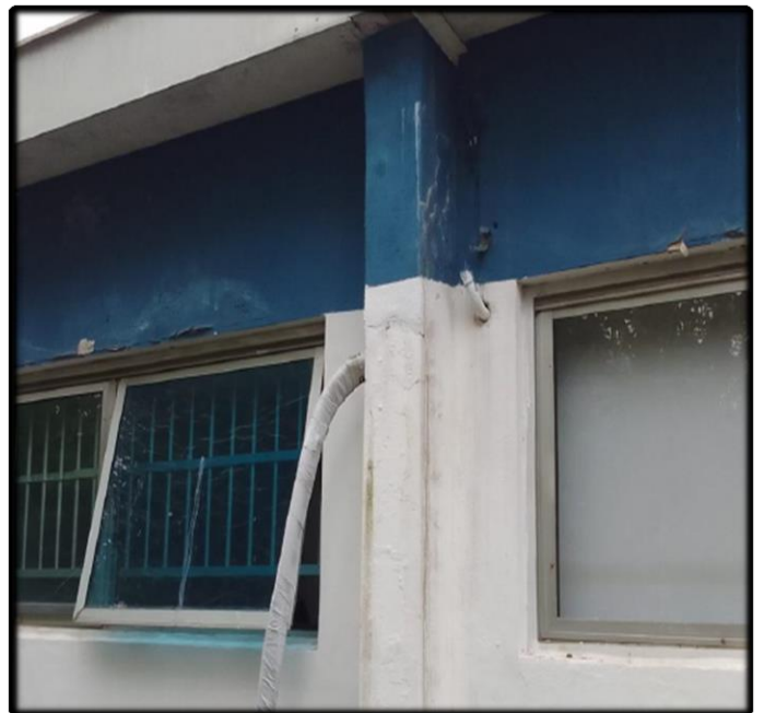
- Infiltração (Área Externa Lateral)
