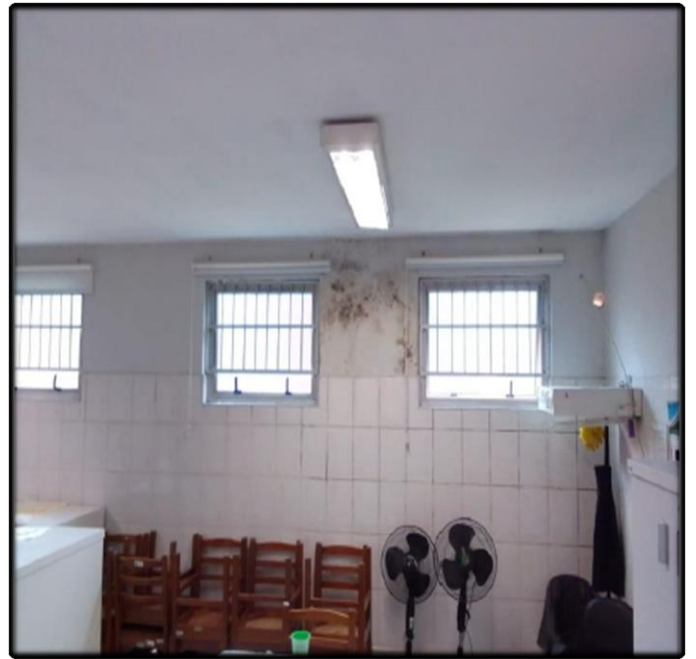
- Mofo e Vazamento (Copa)
