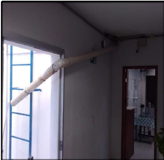
- Intensidade do Vazamento (Copa)
