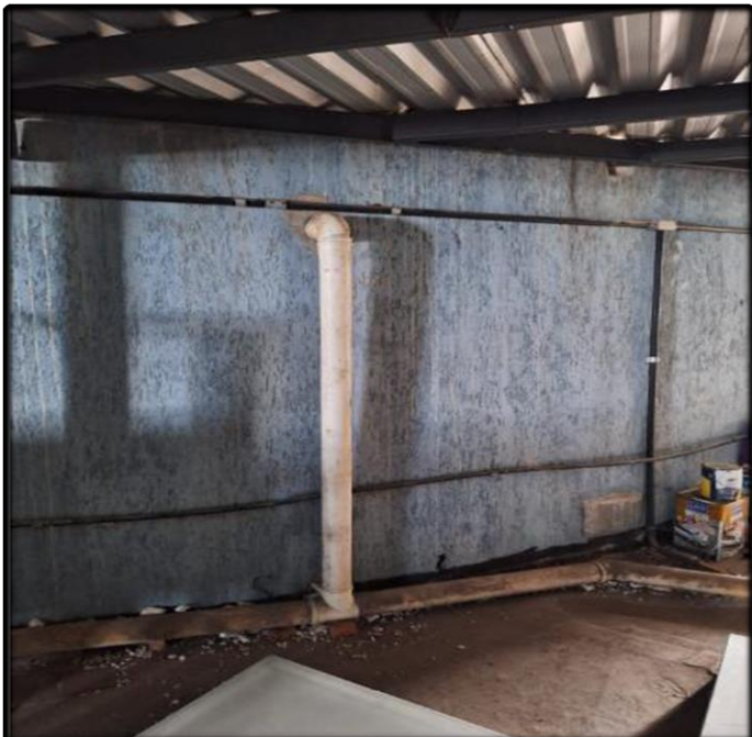
- Rede de Captação e Drenagem (Expostas)
