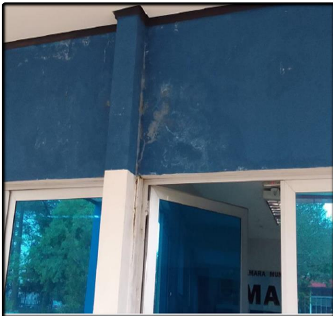
- Infiltrações e Vazamentos (Entrada Principal)
