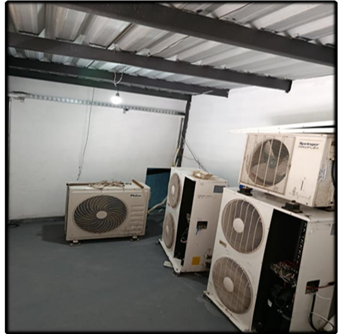
- Casa de Máquinas
