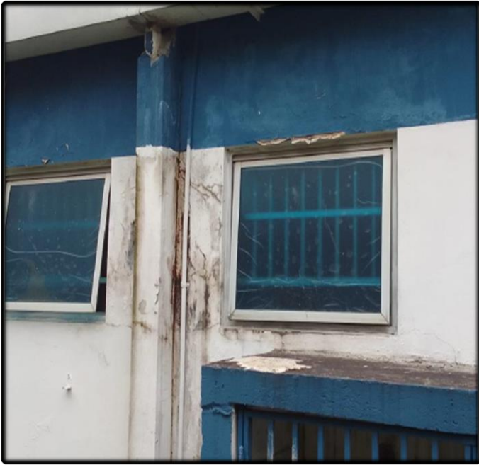
- Infiltração (Área Externa Lateral)
