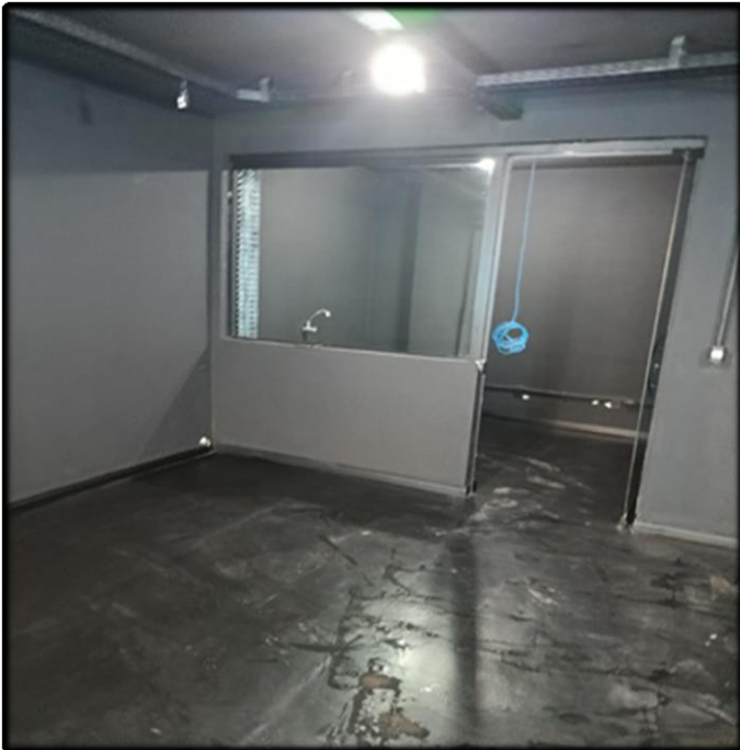
- Visão Geral da Área Técnica da TV Câmara
